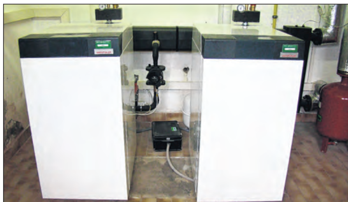
Die neue Heizungsanlage (Brennwerttechnik) an der Regelschule Bürgel, die mit Mitteln des Konjunkturprogrammes II entstand.
