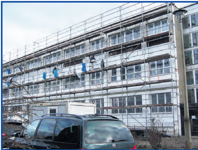
Bauleute der Firma WDVS-Reko-Bau GmbH aus Jena bringen die Wärmedämmplatten an Foto: LRA
